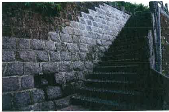
牆體石塊剝落 (3)
