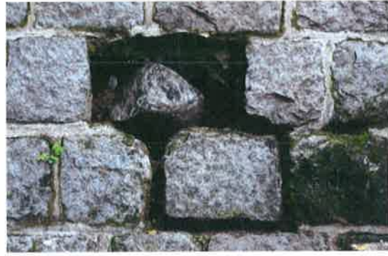
牆體石塊剝落 (3)
