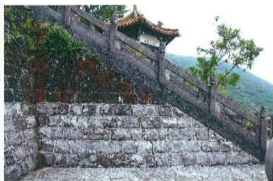
牆體石塊剝落 (1)
