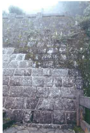
牆體石塊剝落 (4)
