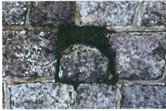
牆體石塊剝落 (2)
