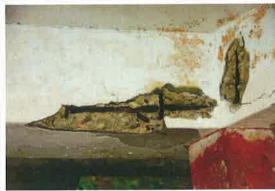
樑的粉刷層剝落，內部鋼筋裸露
