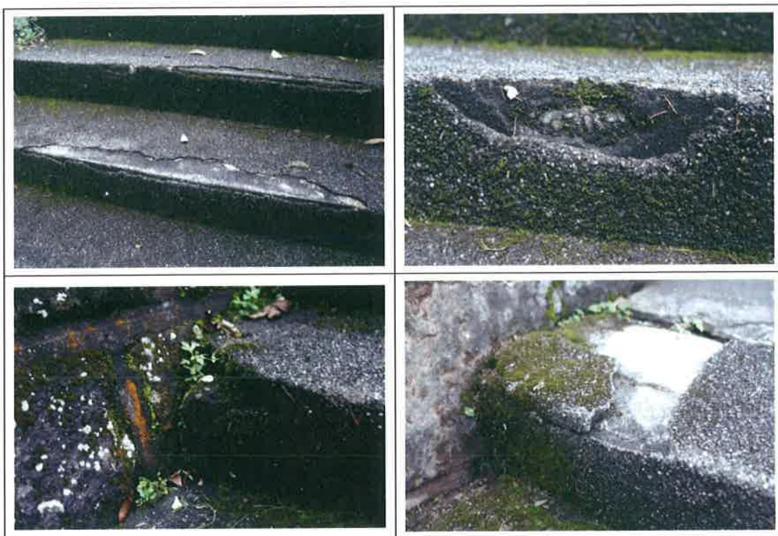
圖 87 毀損狀況示意圖：階梯毀損情況多數以表層鋪面剝落為主，較嚴重者為階梯與牆體相交處。
