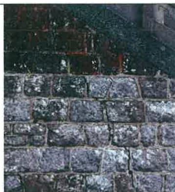
牆體石塊剝落 (1)
