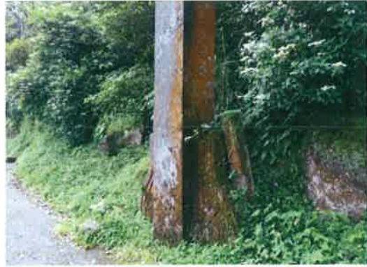
圖 78 牌坊柱子基座有植物攀附
