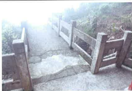
地坪局部毀損
