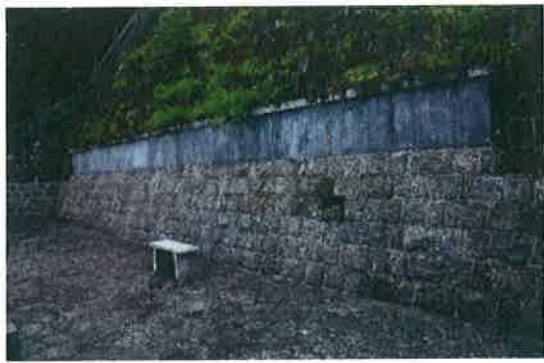
牆體石塊剝落 (2)
